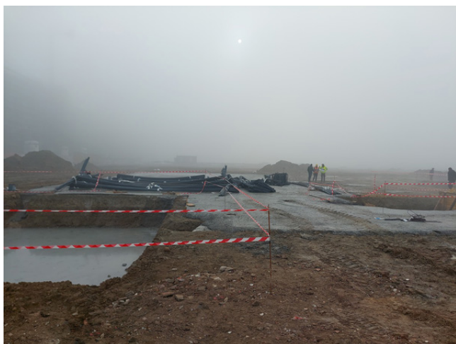
Prime attività ai tracciamenti della platea dopo il consolidamento del terreno con jet-grouting (dicembre 2021)
